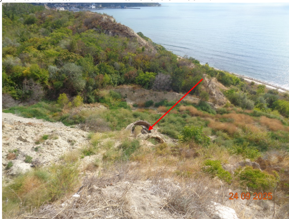
Сн. 7: Разрушената ВШ7
