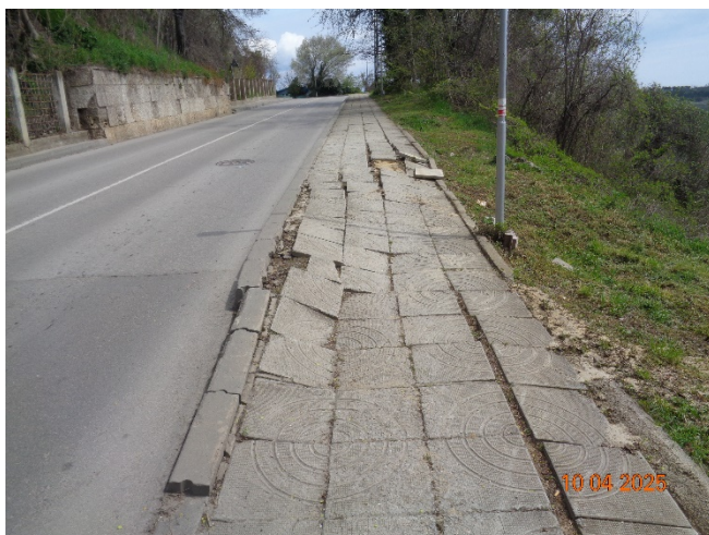
Сн.3. Потъване плочника на тротоара
