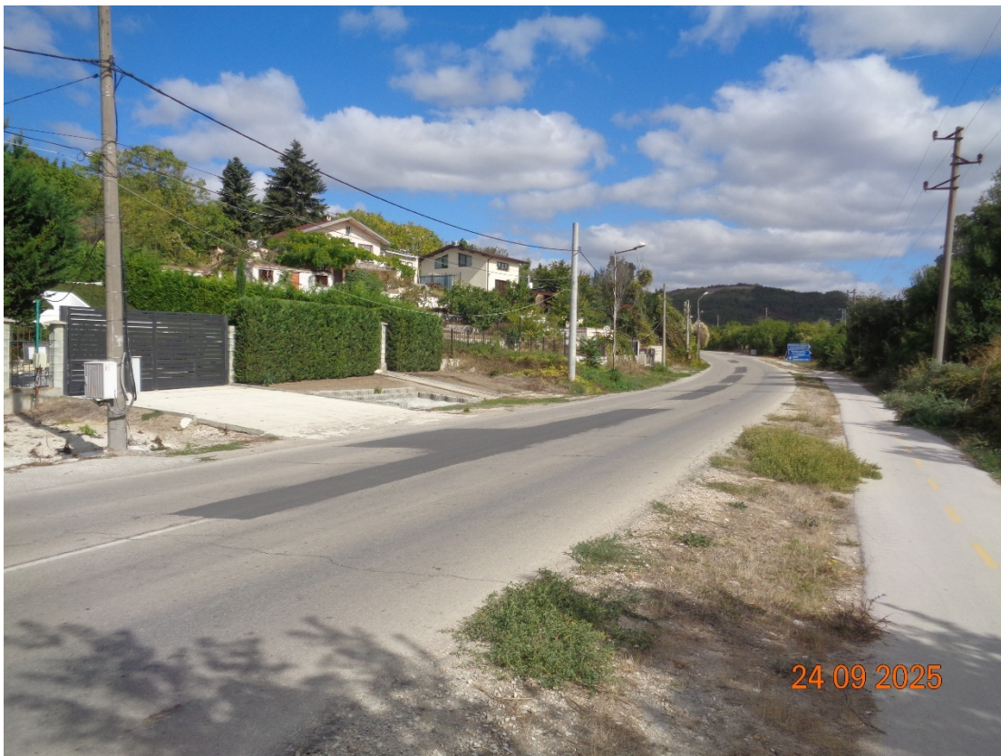
Сн.2: Преасфалтирани пукнатини по осовата линия на пътя (фугата между платната)
