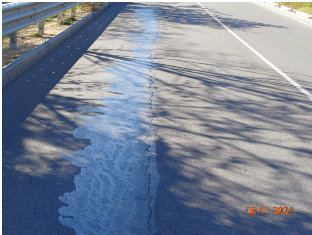
Сн.8: Пукнатини по път I-9
