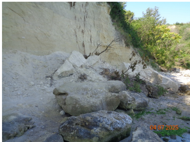
Сн.6: Обрушени пясъци и скални блокове
