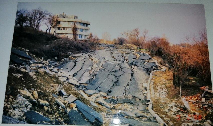
СН.11. Локален свлячищен циркус между профили II и IV - 09.02.98г . Сградата е наклонена по посока на морето
