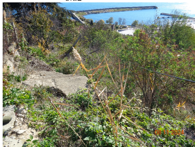
Сн.4: Разрушени стълби
